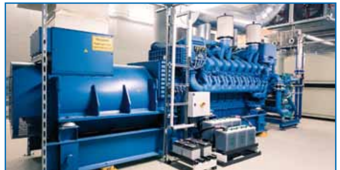
Für den Fall der Fälle - Das Notstromaggregat
